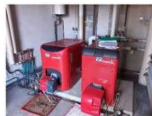
Chaufferie fioul Groupe scolaire
